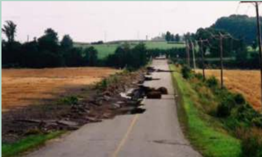
Figure 2: État de la route sur le 13e rang après le débordement de la rivière Bulstrode en 2003 © MRC de l'Érable 1
